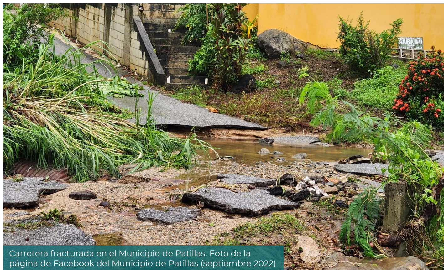
Desprendimiento del puente en el sector Higüero de Jacaboa. Foto de la página de Facebook del Municipio de Patillas (septiembre 2022)
