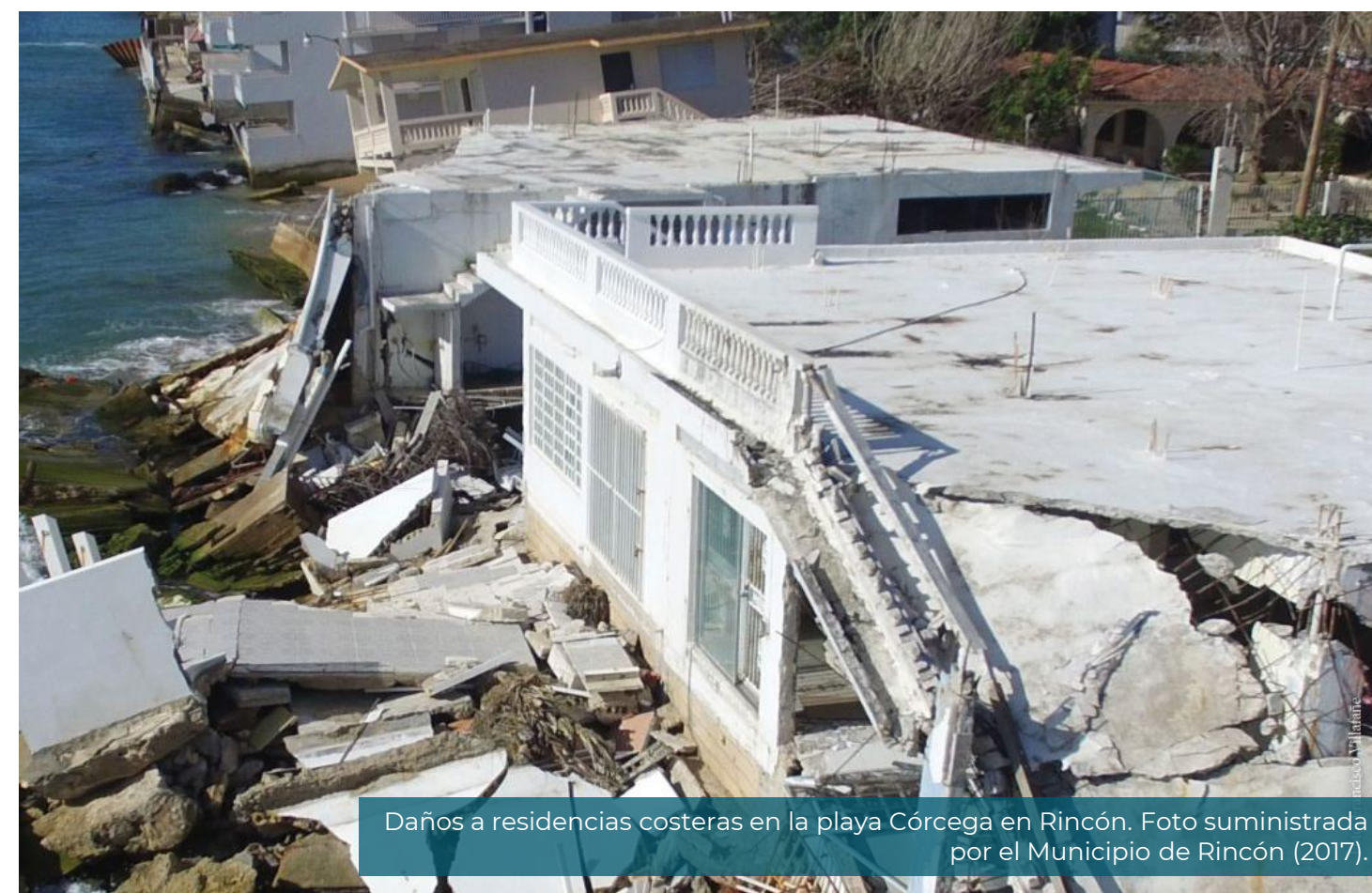
Daños al interior de una residencia en el Municipio. Foto suministrada por el Municipio de Rincón (2017).
